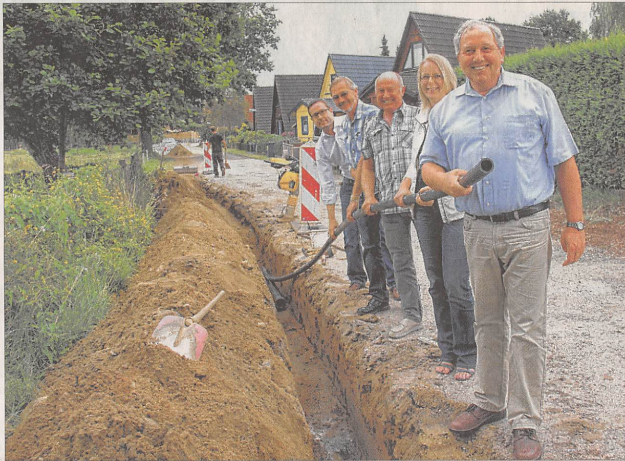
Von rechts: Bürgermeister Dr. Eberhard Laubach, Carina Bresch, Geschäftsführerin Schwarzenbeker Erd- und Tiefbau (SET), Wolfgang Babel, Bauleiter der Stadtwerke, Harry Krause, Bauleiter SET, und Stephan Rakowski, IT-Systemberater der Gudower Firma Client-Server-Networking-Solutions (CSN). Foto: J. Strunk
